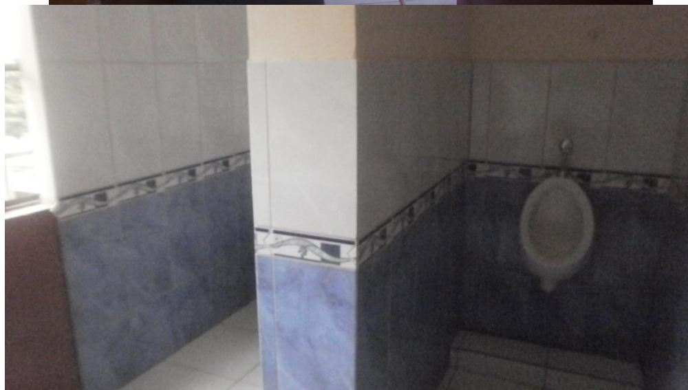
Adecuación de baterías sanitarias en la casa comunal de la parroquia San Roque
