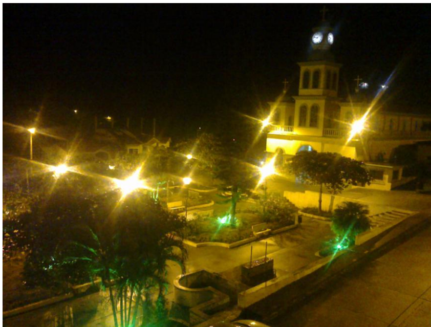
Instalación de reflectores en jardineras del parque central de la parroquia San Roque
